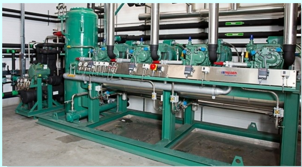
Figuur 6: Overzicht machinekamer
